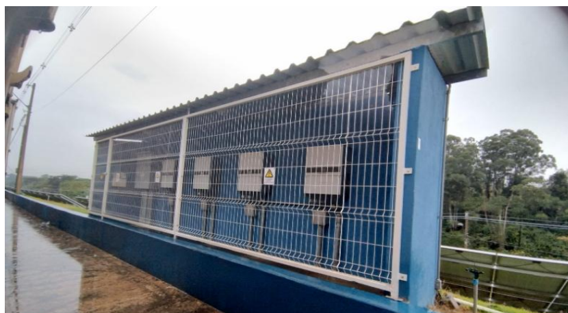
Figura 14: Cabine com aparelho Inversor localizado na Matriz Jundiaí - SP
