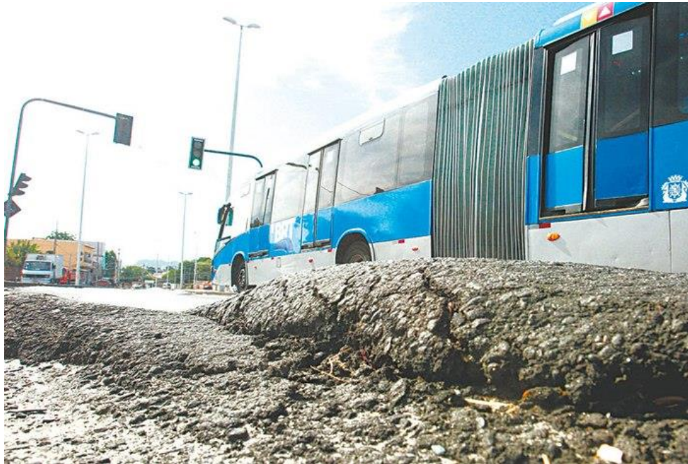
Figura 20 – Pista mal construída
