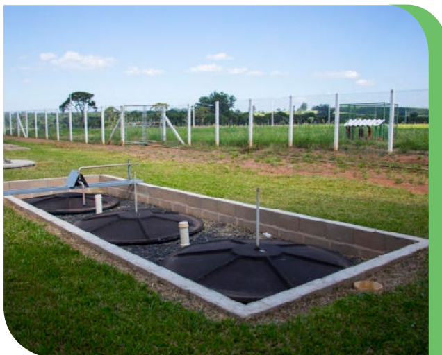
Foto 25: Sistema de fossa séptica
