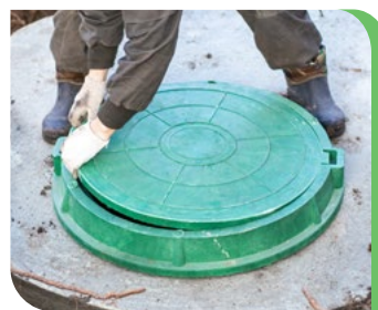
Foto 26: Fossa séptica com presença de escotilha
