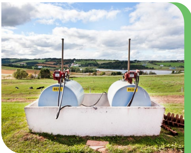
Foto 11: Tanques de armazenamento
