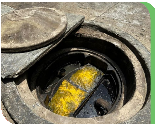
Foto 23: Caixa separadora de água e óleo
