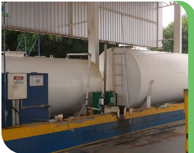
Foto 10: Tanques de armazenamento dotados de bacia de contenção
