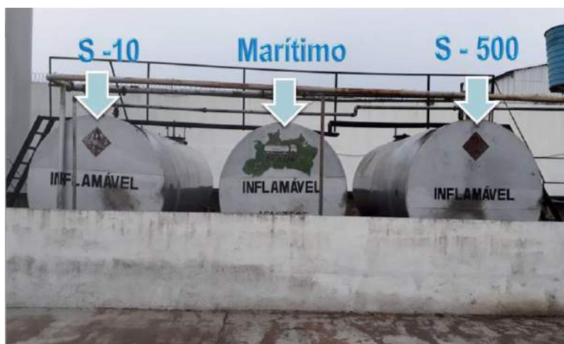
Figura 4 - Tanques Aéreos Horizontais
