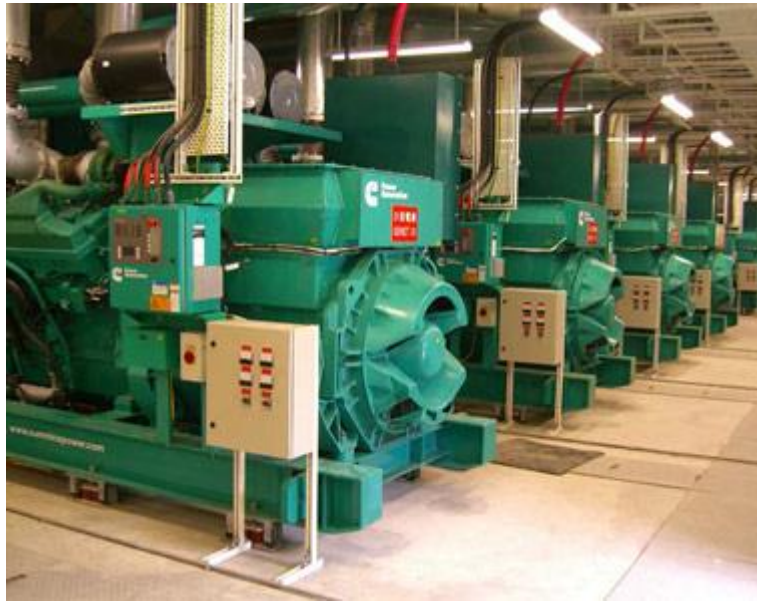
Figura 27 – Grupo de Geradores redundantes
